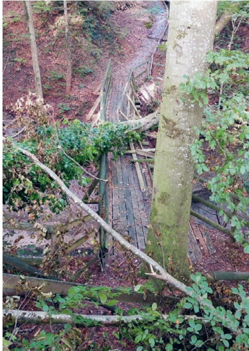
Der Gemeinderat verzichtet auf die Sanierung der Autobelbrücke.
